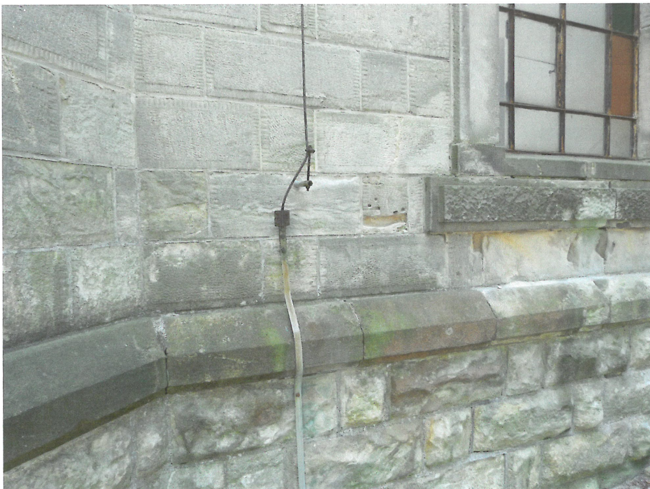
Fot. 15 Fragment elewacji wieży – widoczne ubytki piaskowca .
